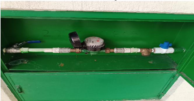
Contador de Agua
