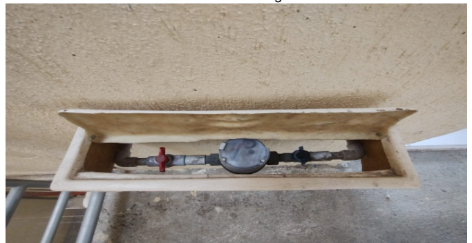
Contador de Agua
