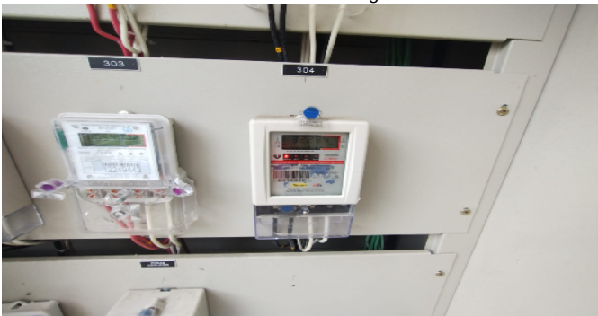
Contador de Energia
