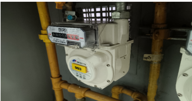
Contador de Gas
