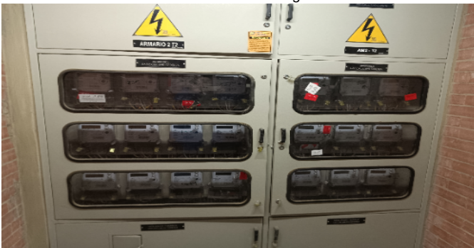
Contador de Energia
