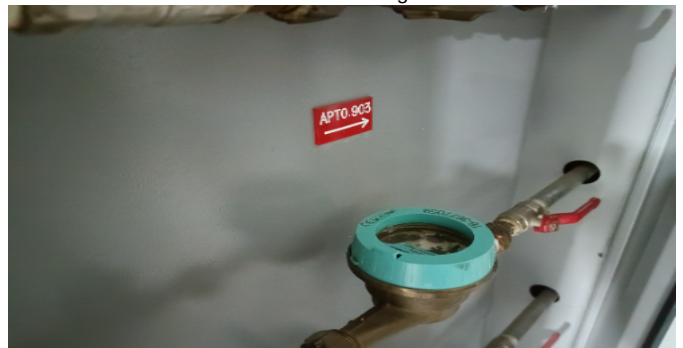
Contador de Agua
