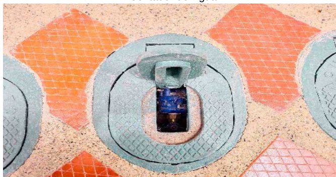
Contador de Agua
