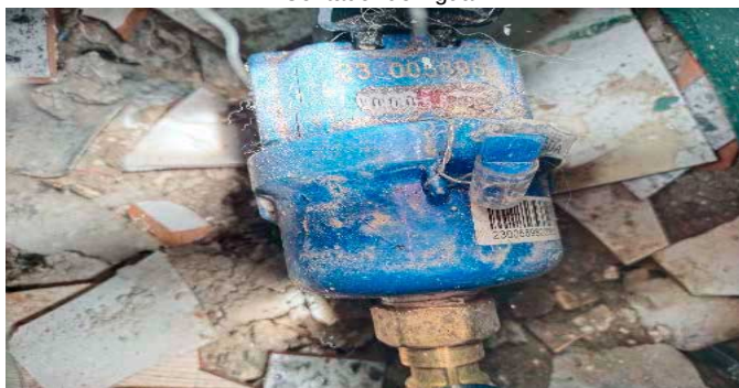
Contador de Agua
