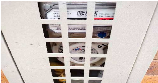
Contador de Gas
