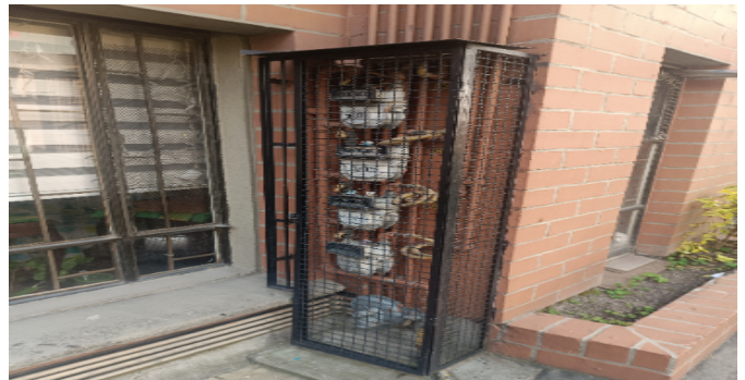
Contador de Gas
