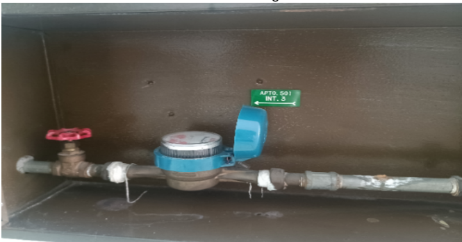
Contador de Agua
