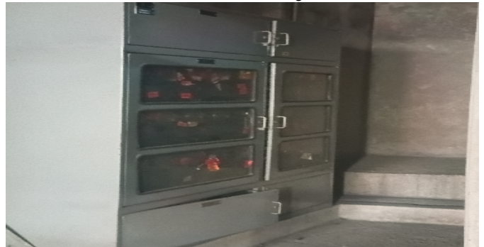
Contador de Energia
