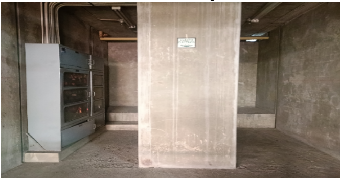
Contador de Energia
