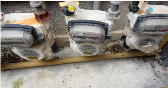
Contador de Gas
