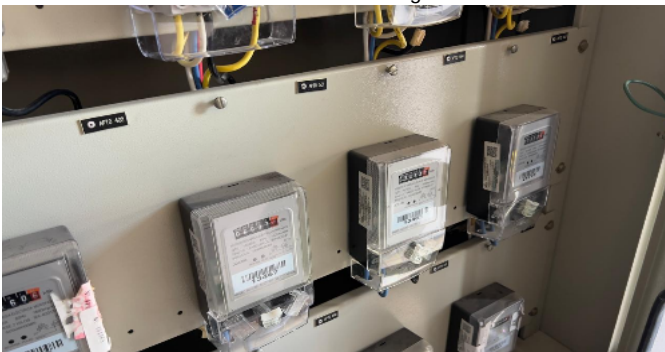
Contador de Energia
