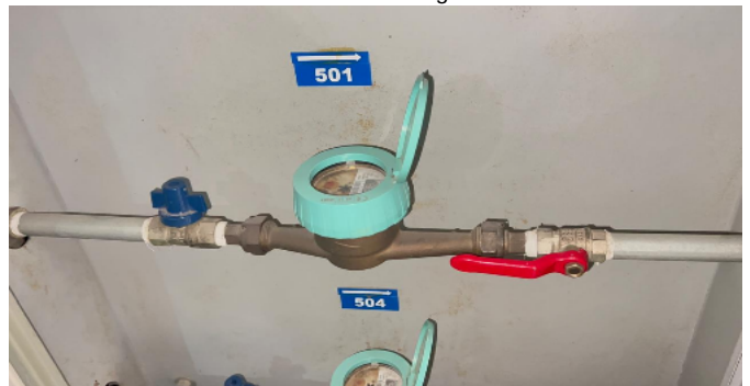
Contador de Agua
