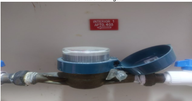
Contador de Agua
