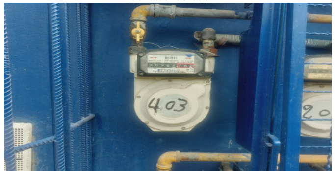
Contador de Gas
