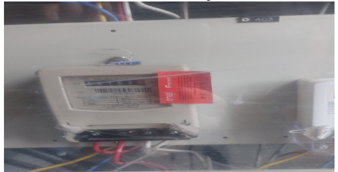
Contador de Energia
