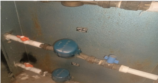
Contador de Agua
