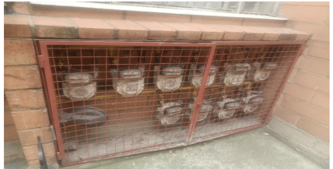
Contador de Gas
