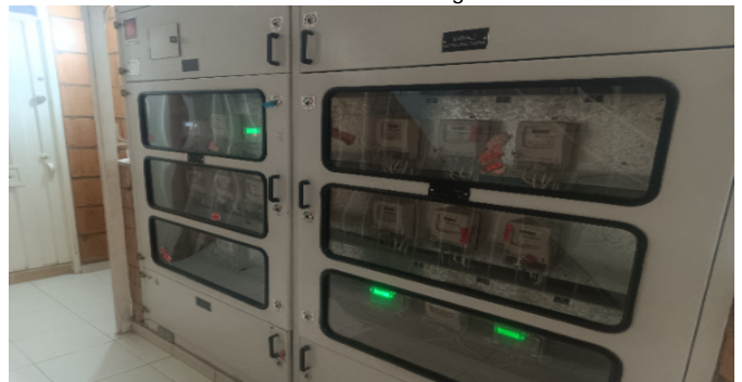
Contador de Energia
