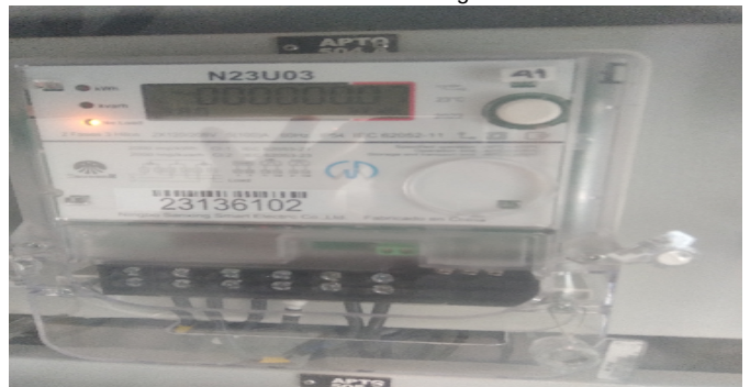
Contador de Energia
