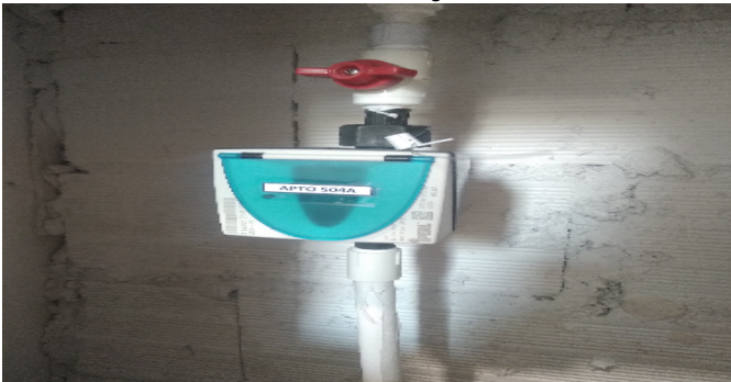
Contador de Agua
