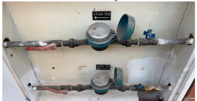
Contador de Agua
