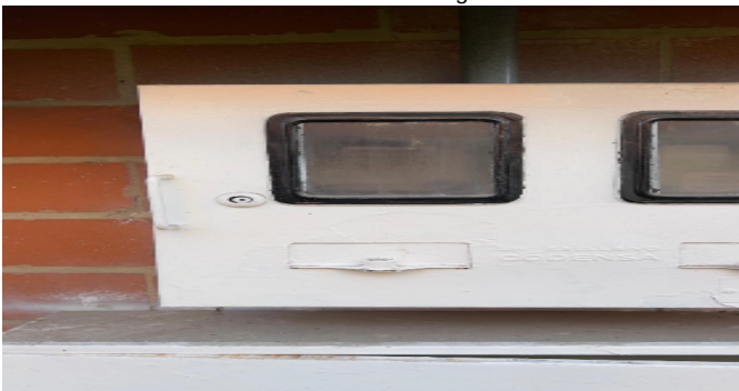
Contador de Energia
