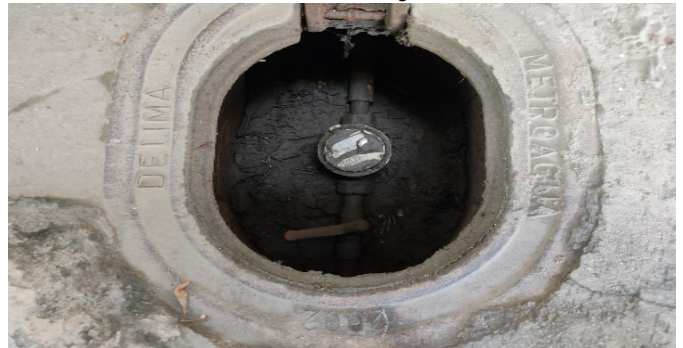
Contador de Agua
