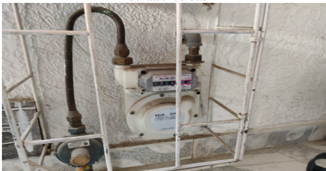
Contador de Gas
