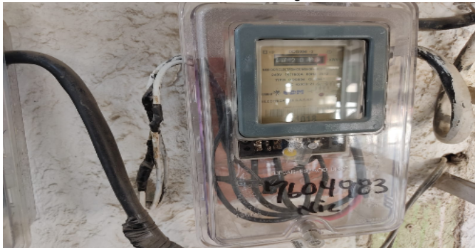
Contador de Energia
