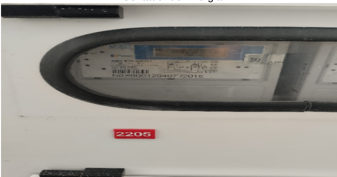
Contador de Energia
