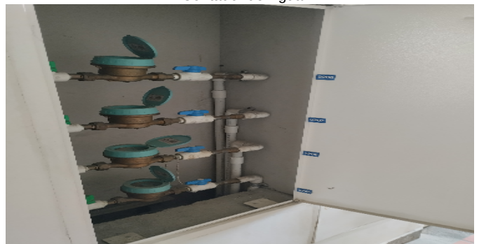
Contador de Agua
