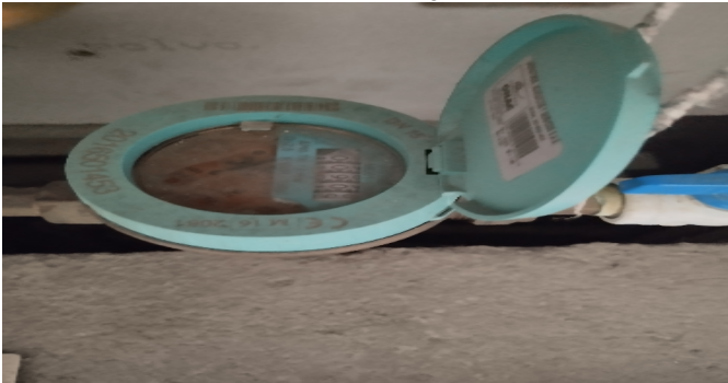
Contador de Agua
