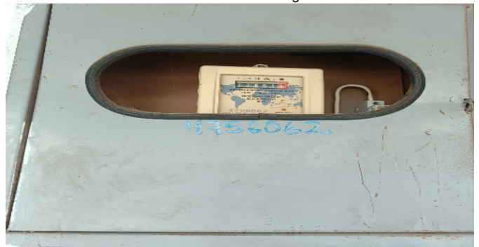
Contador de Energia
