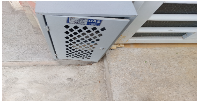
Contador de Gas
