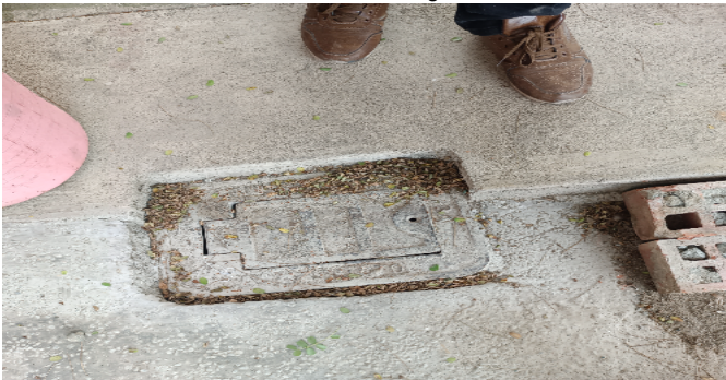
Contador de Agua
