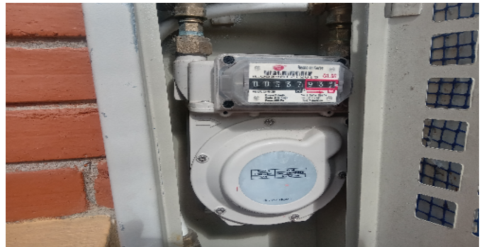
Contador de Gas
