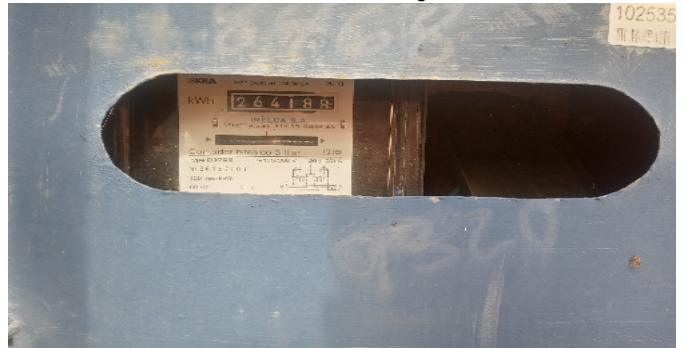
Contador de Energia
