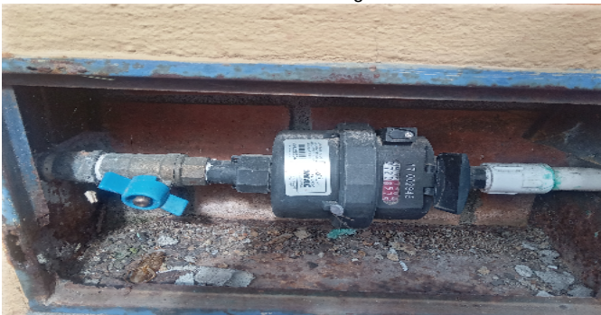
Contador de Agua
