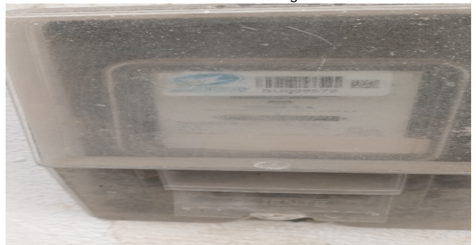
Contador de Energia
