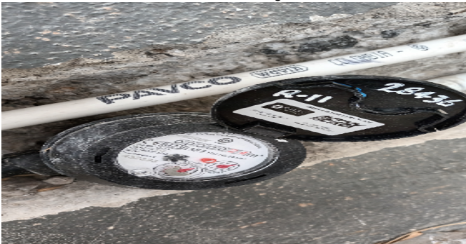
Contador de Agua
