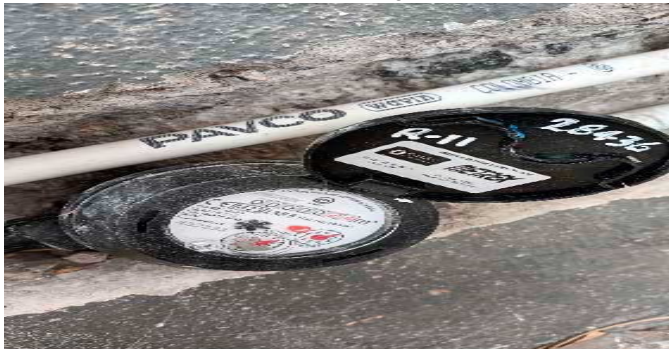
Contador de Agua
