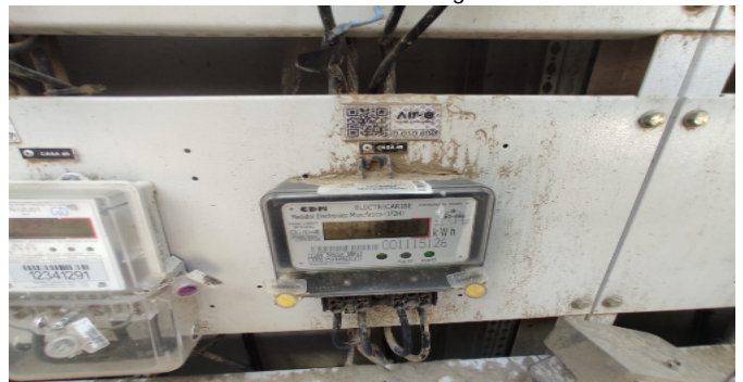
Contador de Energia
