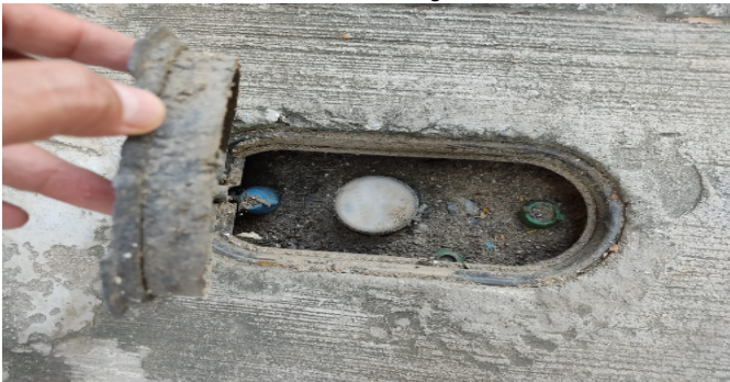
Contador de Agua
