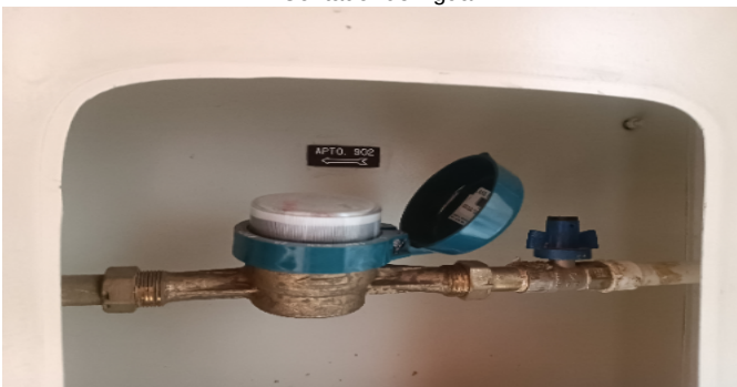
Contador de Agua
