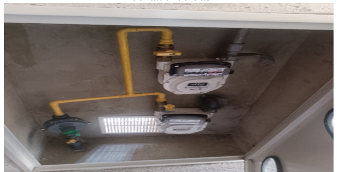
Contador de Gas
