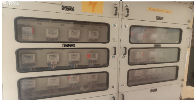
Contador de Energia
