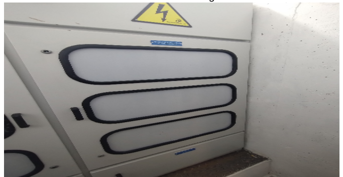
Contador de Energia
