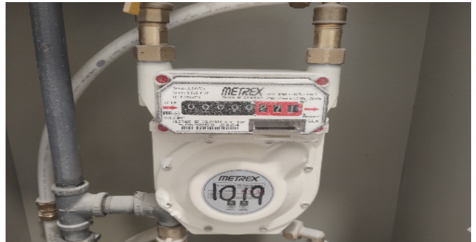
Contador de Gas
