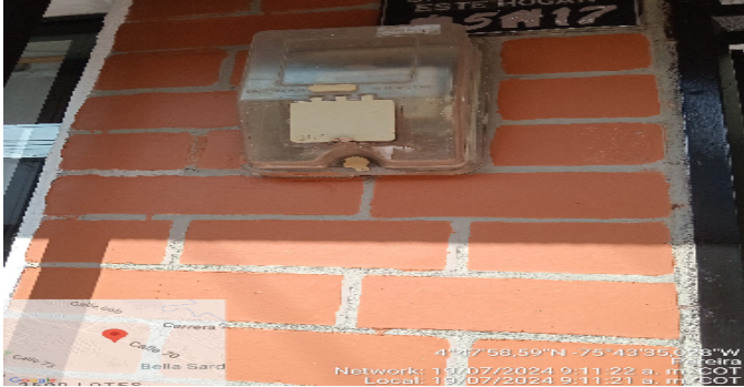
Contador de Energia
