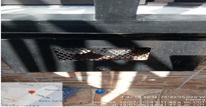
Contador de Gas
