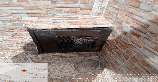
Contador de Agua
