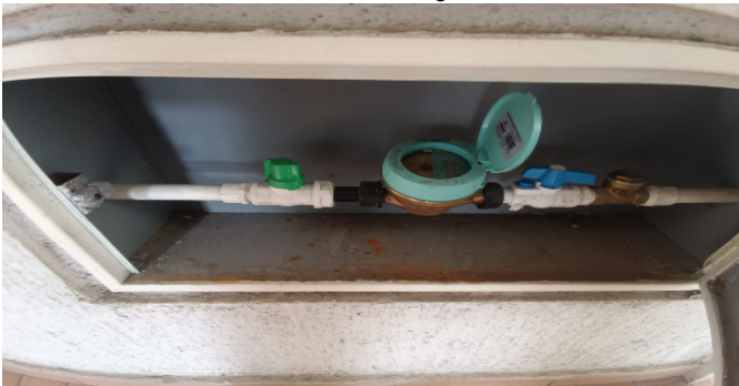
Contador de Agua
