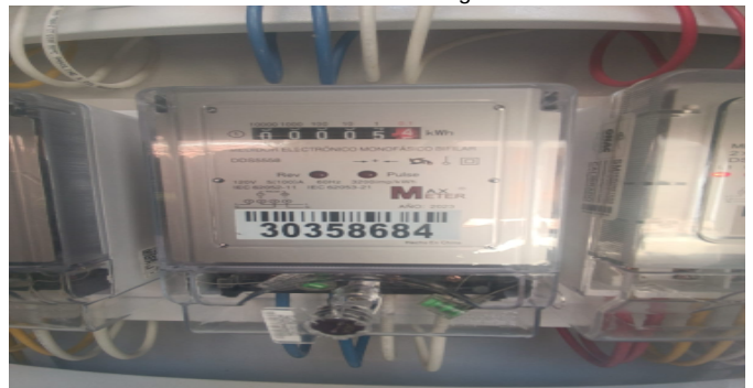
Contador de Energia
