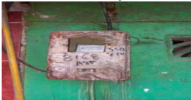
Contador de Energia
