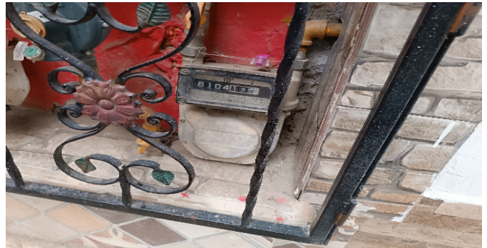
Contador de Gas
