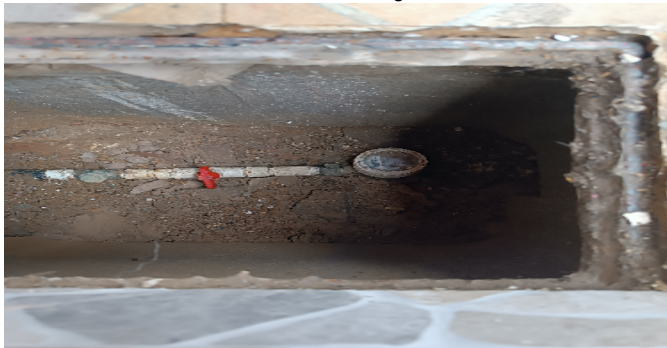
Contador de Agua
