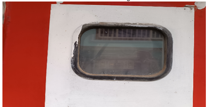
Contador de Energia
