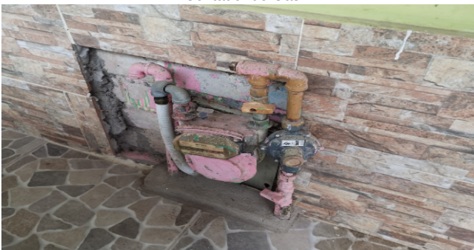
Contador de Gas
