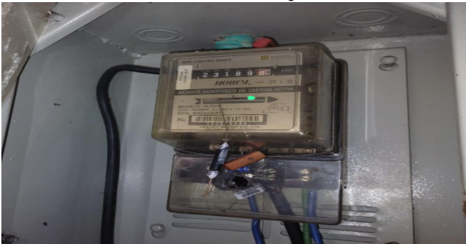
Contador de Energia
