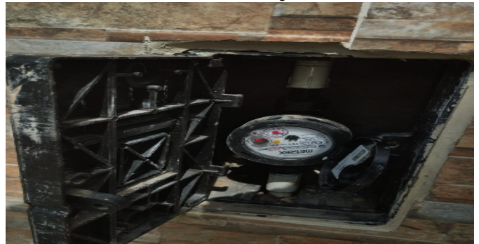
Contador de Agua
