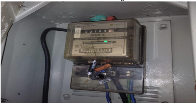
Contador de Energia
