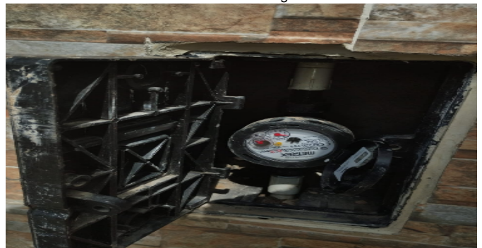
Contador de Agua
