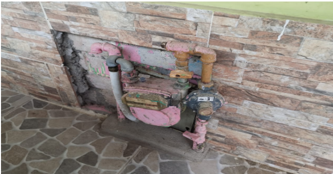
Contador de Gas
