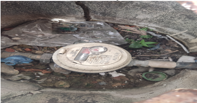
Contador de Agua
