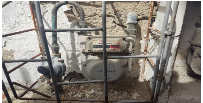
Contador de Gas
