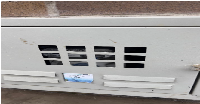
Contador de Gas
