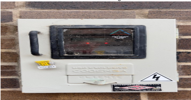
Contador de Energia
