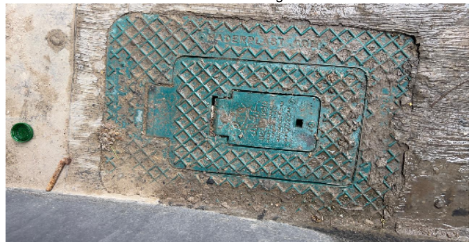
Contador de Agua
