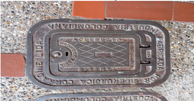
Contador de Agua
