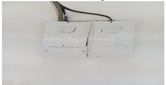
Contador de Energia
