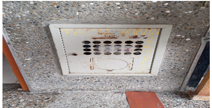
Contador de Gas
