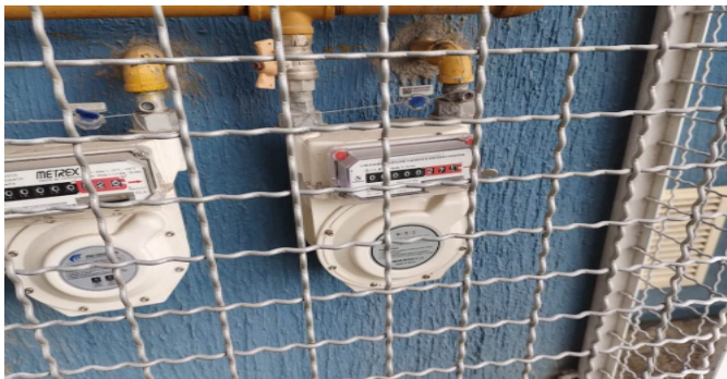
Contador de Gas
