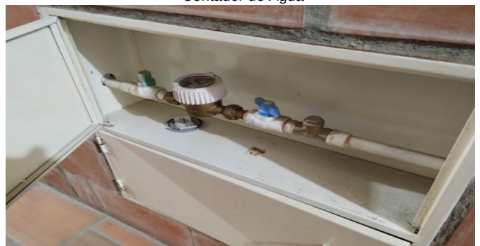
Contador de Agua
