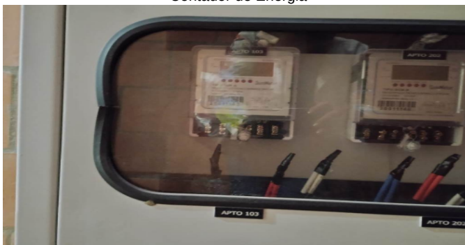
Contador de Energia
