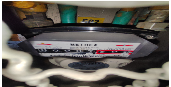
Contador de Gas
