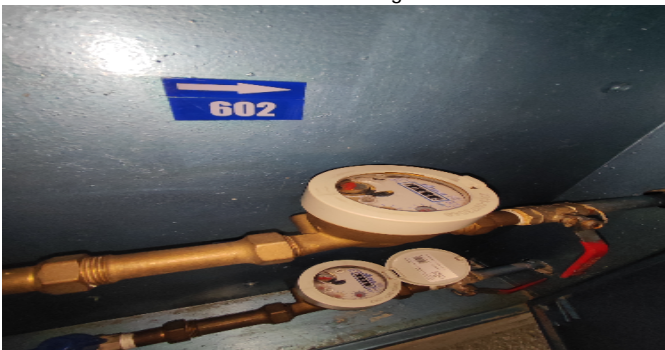
Contador de Agua
