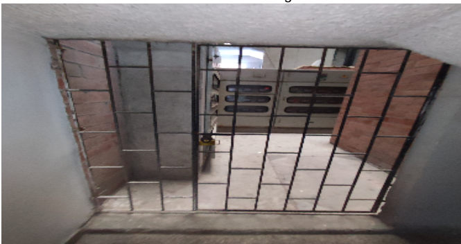
Contador de Energia
