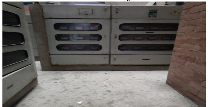
Contador de Energia
