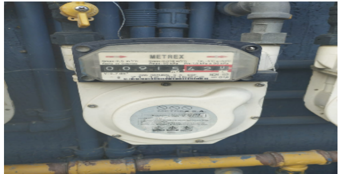
Contador de Gas
