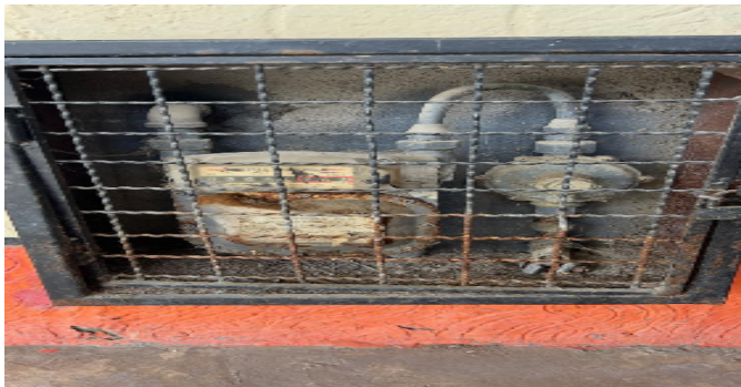
Contador de Gas
