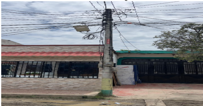
Contador de Energia
