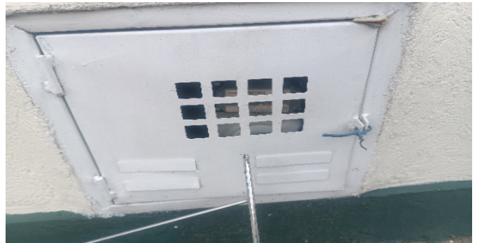
Contador de Gas
