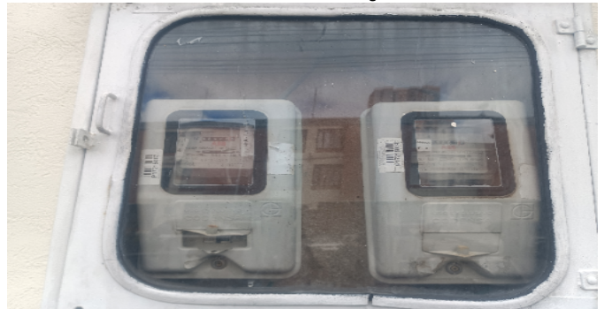
Contador de Energia
