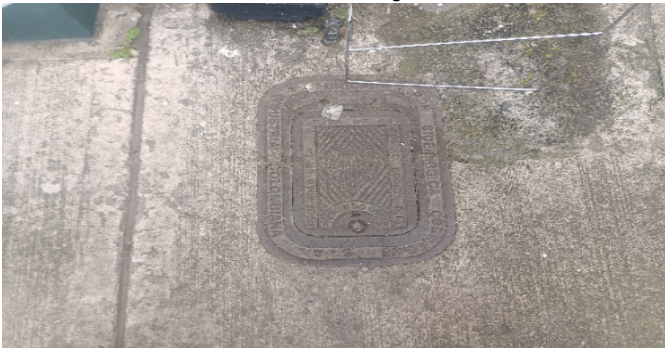
Contador de Agua
