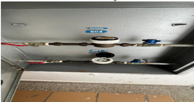
Contador de Agua
