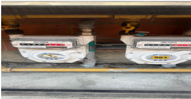
Contador de Gas
