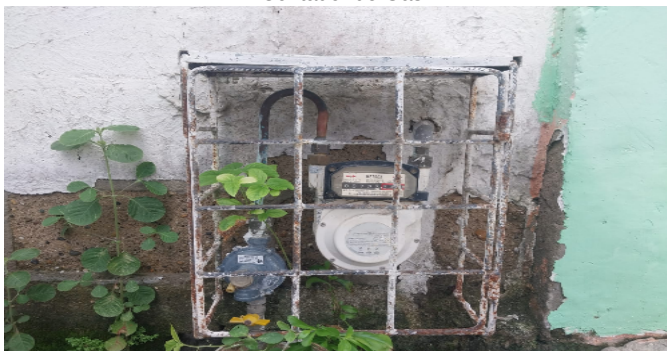
Contador de Gas
