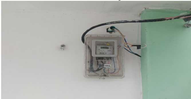
Contador de Energia
