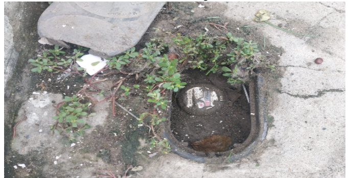
Contador de Agua
