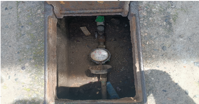
Contador de Agua
