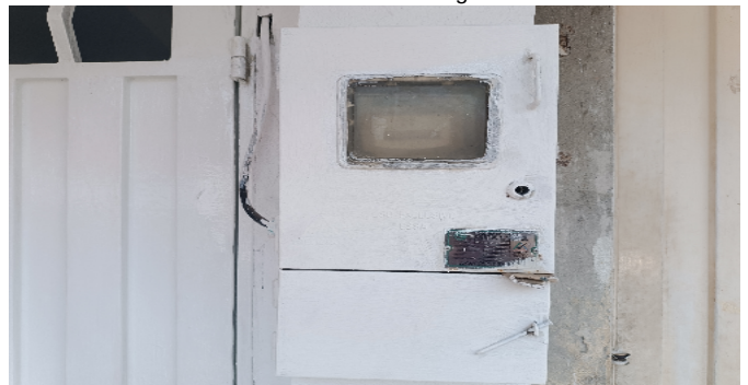
Contador de Energia
