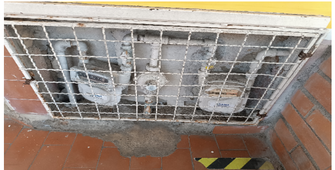
Contador de Gas
