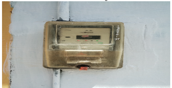
Contador de Energia
