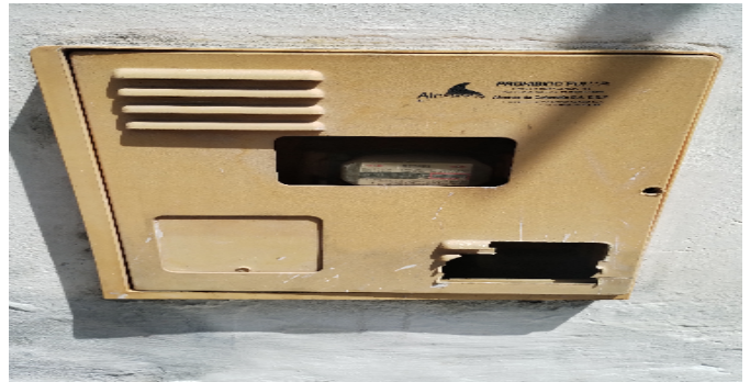
Contador de Gas
