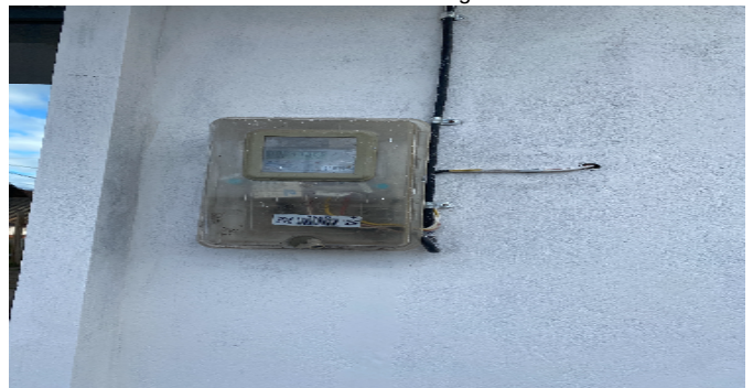
Contador de Energia
