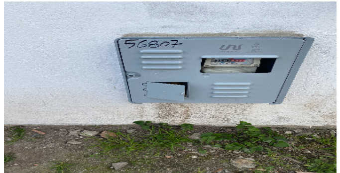
Contador de Gas
