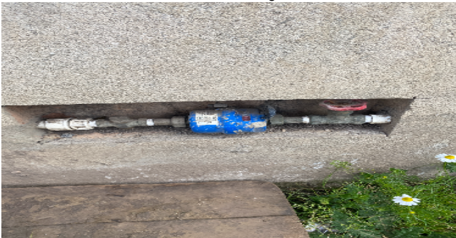
Contador de Agua
