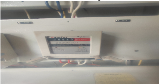
Contador de Energia
