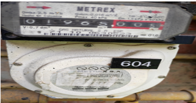
Contador de Gas
