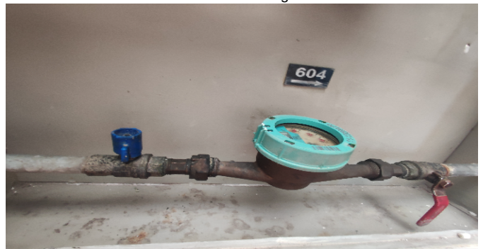
Contador de Agua
