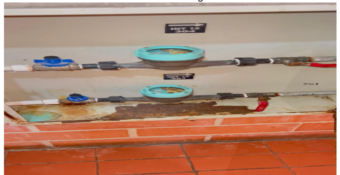
Contador de Agua
