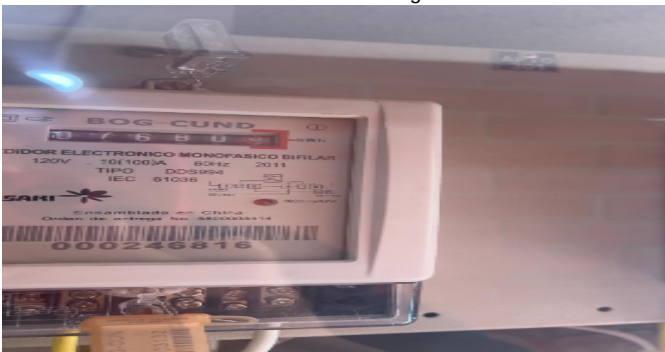
Contador de Energia
