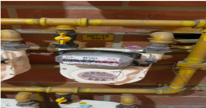
Contador de Gas
