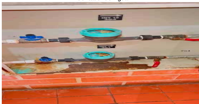
Contador de Agua
