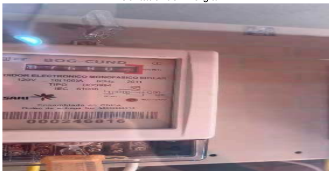
Contador de Energia
