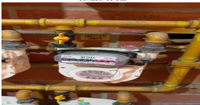
Contador de Gas
