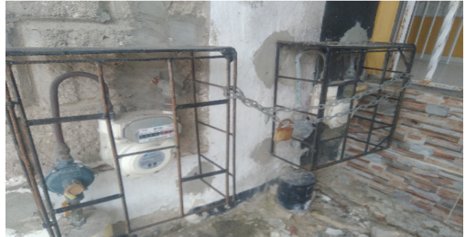
Contador de Gas
