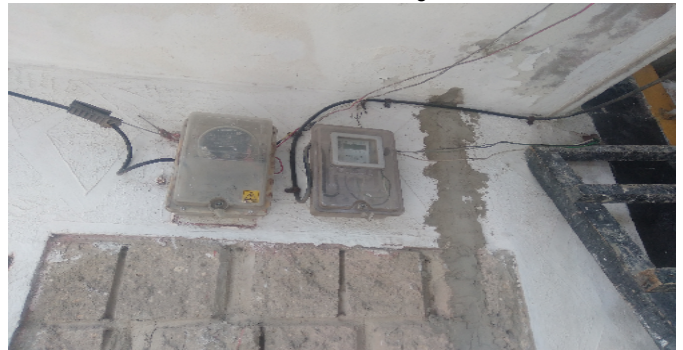
Contador de Energia
