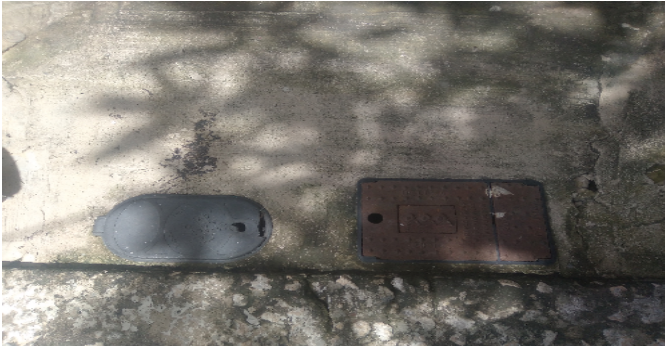
Contador de Agua
