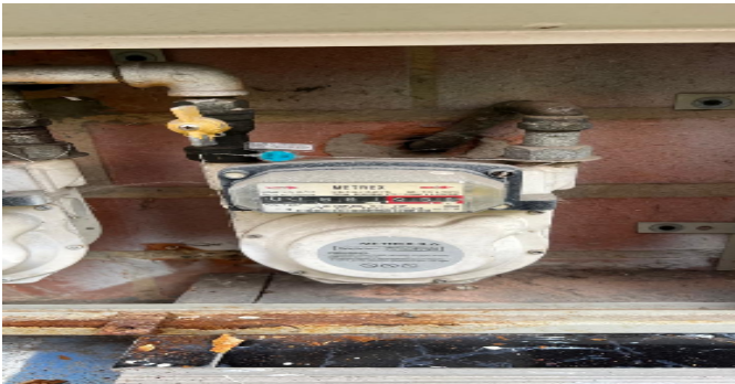
Contador de Gas
