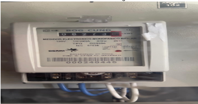
Contador de Energia
