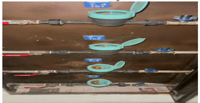
Contador de Agua
