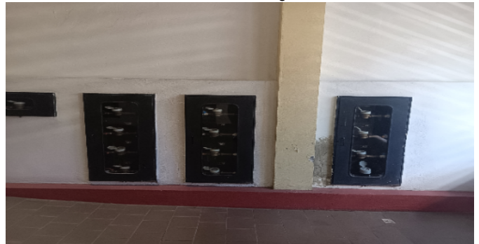
Contador de Agua
