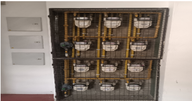
Contador de Gas
