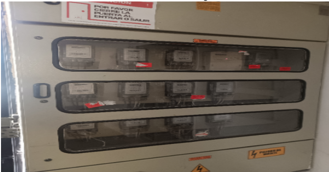
Contador de Energia
