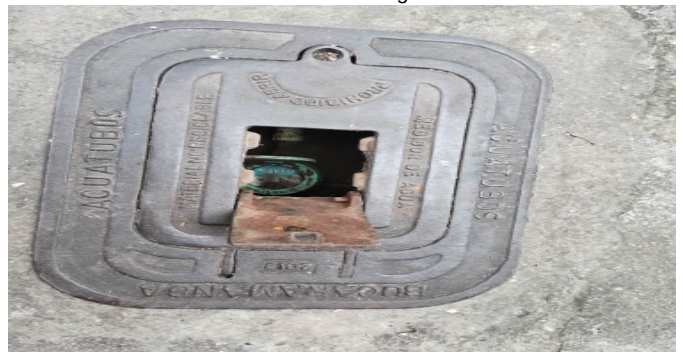
Contador de Agua
