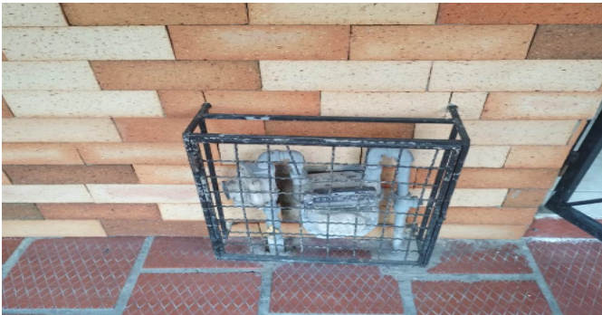
Contador de Gas
