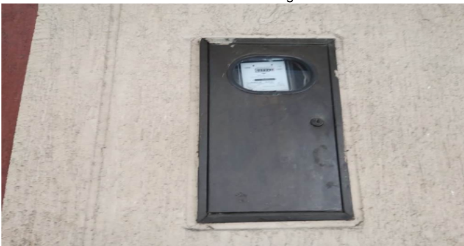
Contador de Energia
