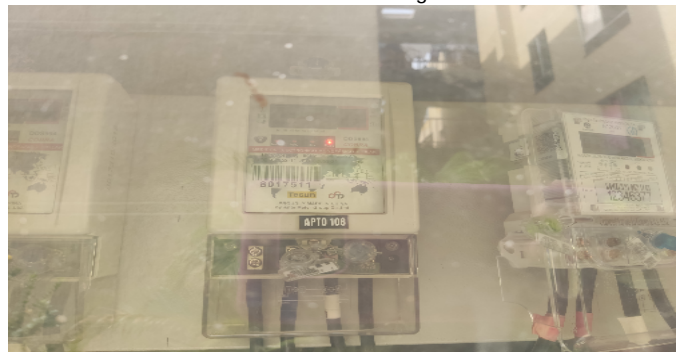
Contador de Energia
