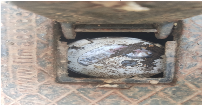
Contador de Agua
