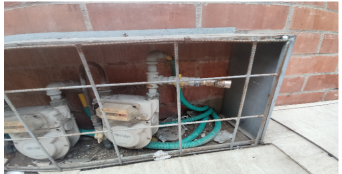
Contador de Gas
