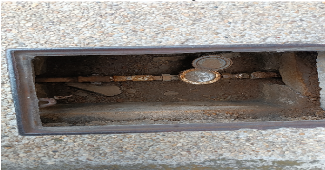
Contador de Agua
