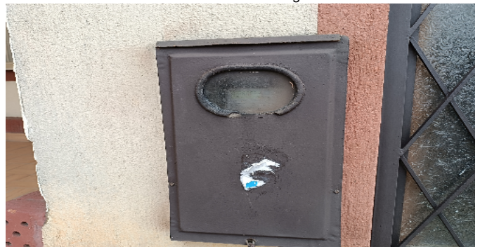
Contador de Energia
