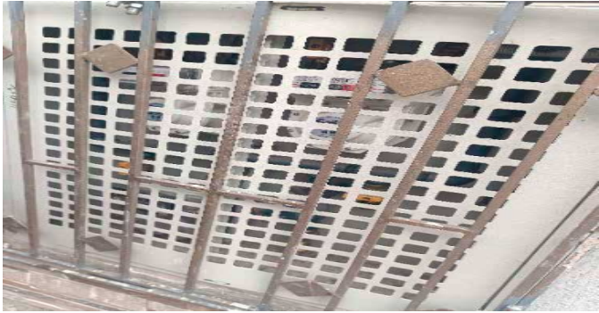
Contador de Gas
