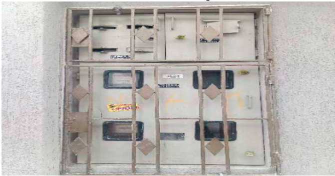
Contador de Energia
