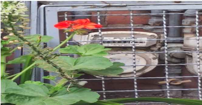
Contador de Gas
