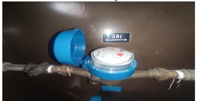
Contador de Agua
