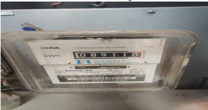
Contador de Energia
