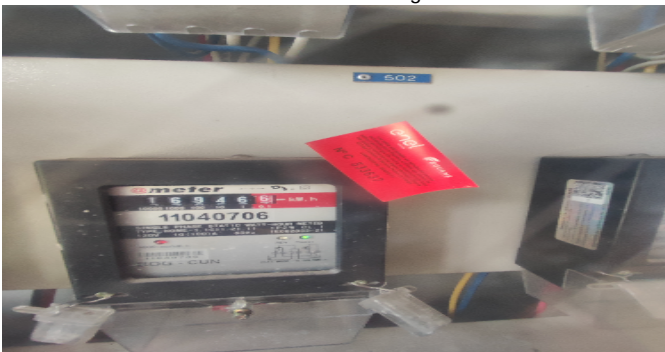
Contador de Energia
