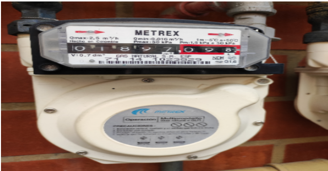
Contador de Gas
