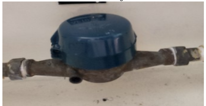
Contador de Agua
